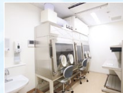
がん病棟に設置された抗がん剤を調剤するアイソレーター。
