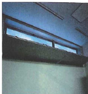
自然排煙による排煙口の例
