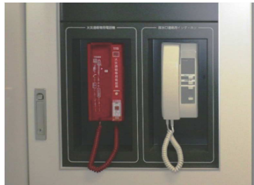
（右は採水口連絡用インターホン） （総合外来センター1階 防災センター）
